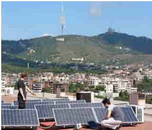
FOTO 15. Vista de paneles solares.
