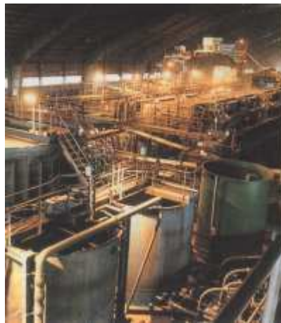
FOTO 6. Instalaciones de una central térmica.
