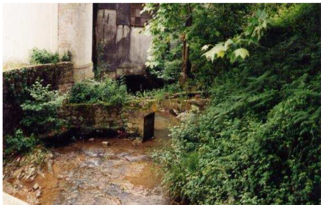
FOTO 4. El río a su paso por los polígonos industriales recibe una gran carga contaminante.
